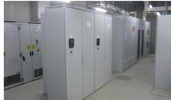
Um- und Neubauten zur Effizienzsteigerung: Hier die Niedrigtemperatur-Trocknungsanlage
